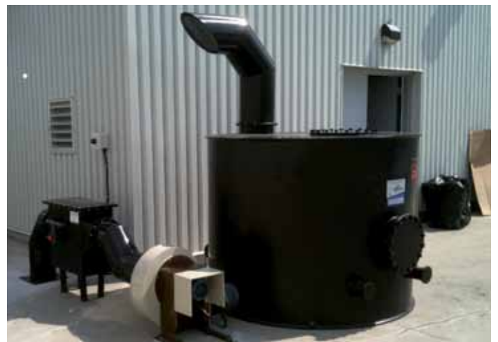
TCA, son ventilateur et séparateur de gouttes en STEP
