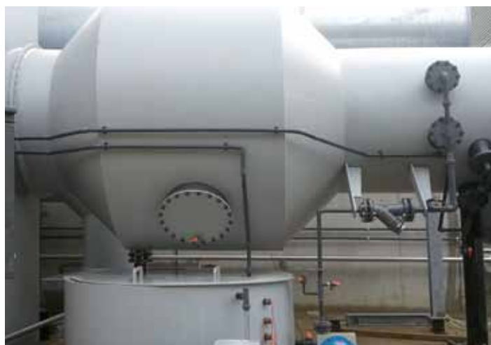
LCP en prétraitement de biofiltration
