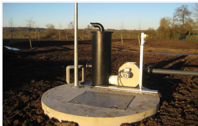
NAT extérieure sur Poste de Relevage
