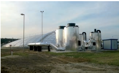
Stations d'épuration des eaux usées collectives
