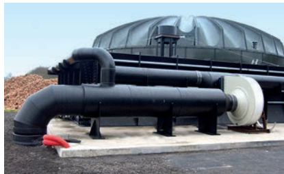
Stations d'épuration des eaux usées industrielles
