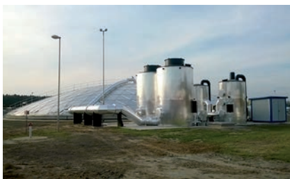
Planta depuradoras de aguas residuales urbanas
