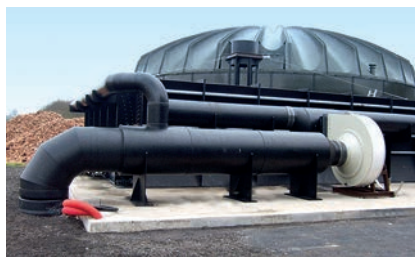
Planta depuradoras de aguas residuales industriales
