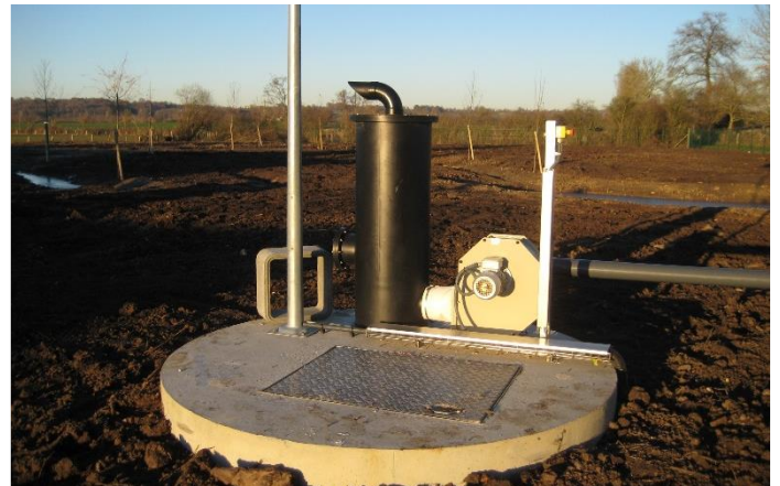
NAT extérieure sur Poste de Relevage
